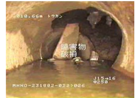
管路施設の劣化
