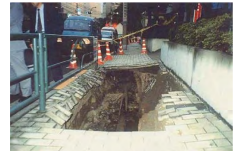
管路施設に起因した陥没
