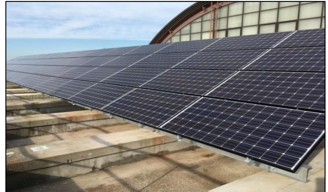
市民総合体育館に設置された太陽光発電設備
