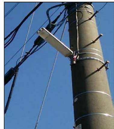
自治会助成により設置されたLED防犯灯
