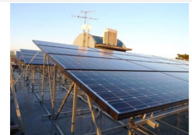
【事業所に設置された太陽光発電設備】
